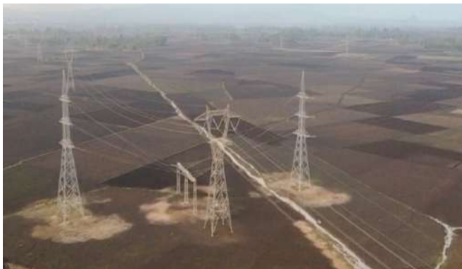
WODA 230KV Transmission
